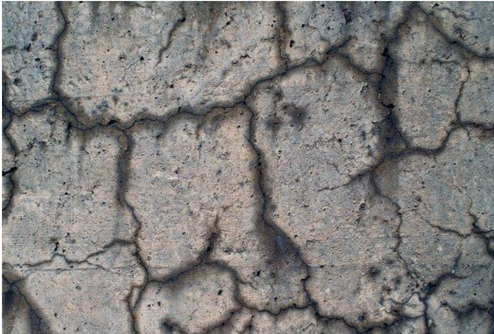
Figura 5 – Reação álcali agregado em estruturas de concreto
