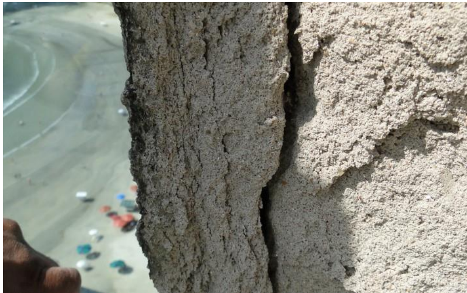
Figura 4 – Expansão por sulfato ocasionado em estruturas de concreto
