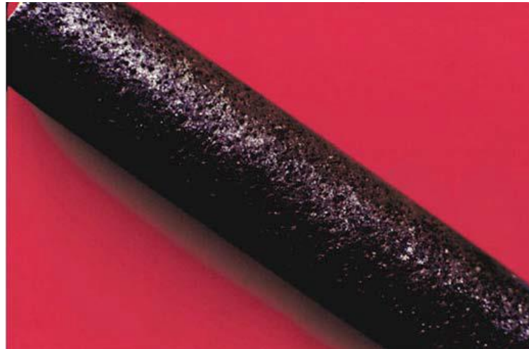
Figura 7 – Pite em tubo de aço-carbono
